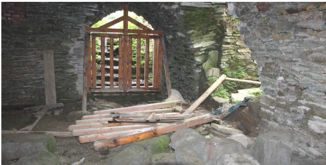
Dochovaná místnost s valenou klenbou opět bez zajištění a důstojného úklidu, foto R. Dušek, 2014
